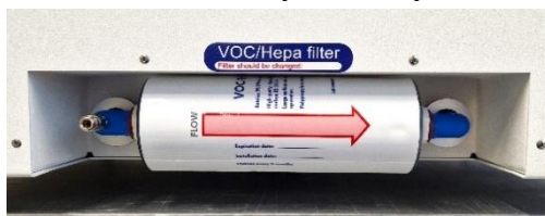
Figura 12.3 Filtro COV/HEPA instalado corretamente
